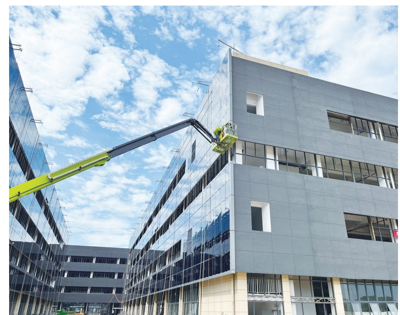
皖能江南电子信息产业园项目主体工程目前已基本建成，正在进行厂房内外装修和附属工程施工，预计8月份竣工验收。
