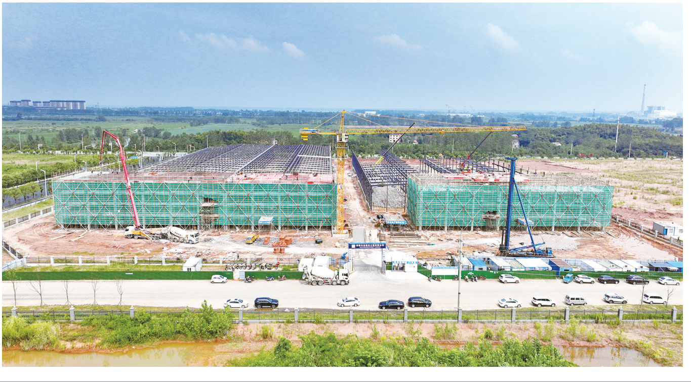
图为安徽沉翰科技有限公司沉翰精密机械产业基地项目建设现场。该项目总投资10亿元,于今年3月份正式开工建设,分两期建设。项目建成投产后,可形成年产2000万套(件)汽车零部件及手机部件和年产1000万套(件)半导体IGBT散热器的生产能力,实现年产值15亿元。
